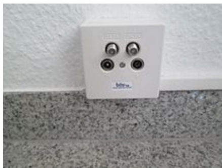
Figure III.5. Exemple de prise d'abonné
