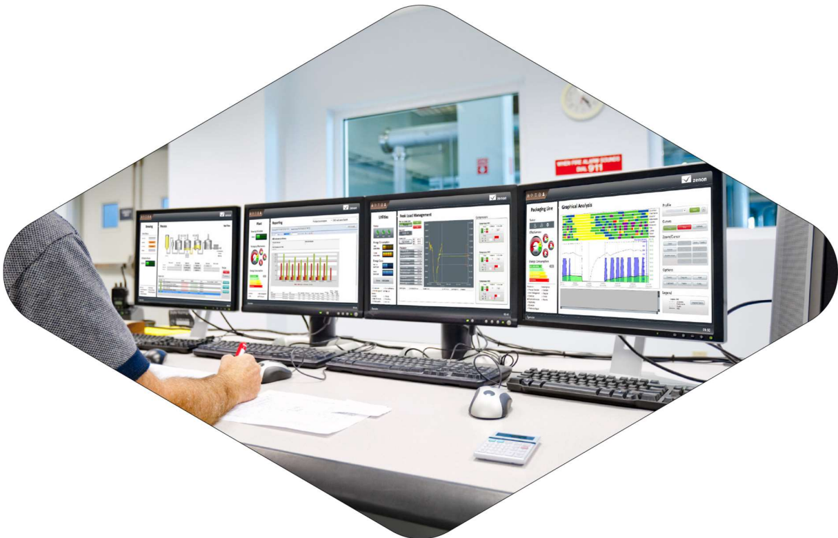
Salle de contrôle et de commande
